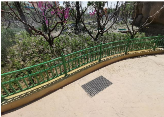
区域内雨水排水井
