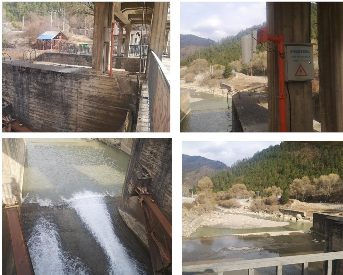
生态下泄流量监控设施
