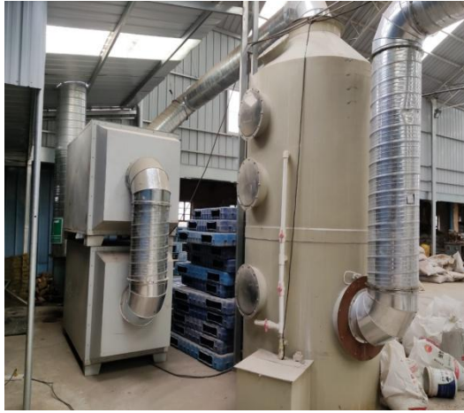
喷淋塔+UV 光氧化+活性炭废气处理系统
