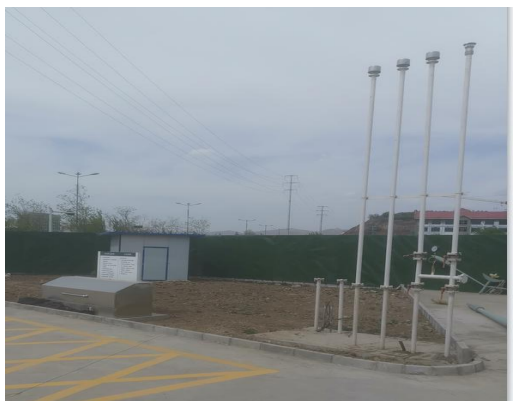
油气回收装置
