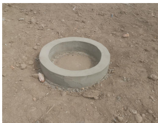
地下水监控井
