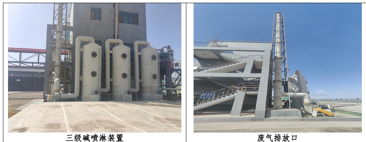
图 4.1-1 废气治理设施
