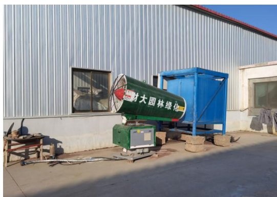
有机肥厂区喷淋除臭设施
