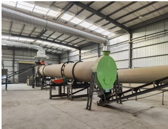
有机肥生产车间废气收集系统
