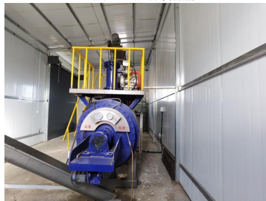
化制机废气收集系统
