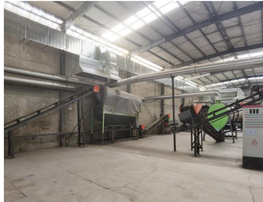
有机肥生产车间废气收集系统
