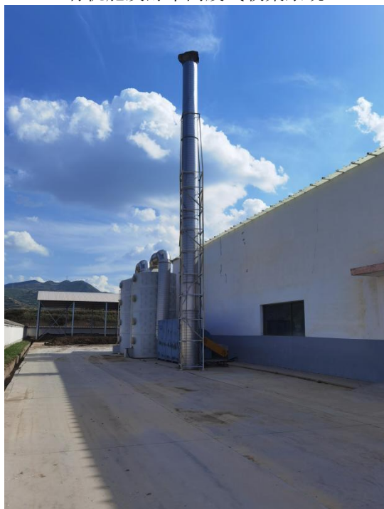
有机肥发酵车间废气处理系统
