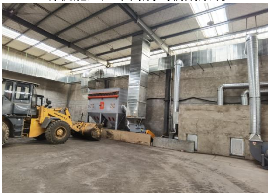
有机肥生产车间布袋除尘器
