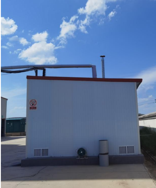
1.2t/h 蒸汽锅炉排气筒
