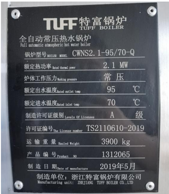
2.1MW 燃气热水锅炉铭牌
