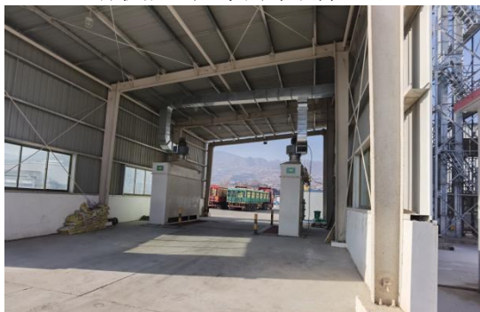
饲料加工厂区卸料口粉尘布袋除尘器
