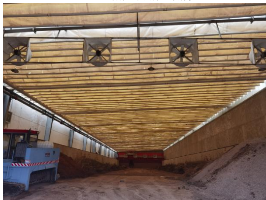
有机肥发酵车间废气收集系统
