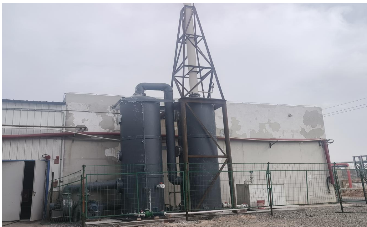
液氯库房应急废气处理设施
