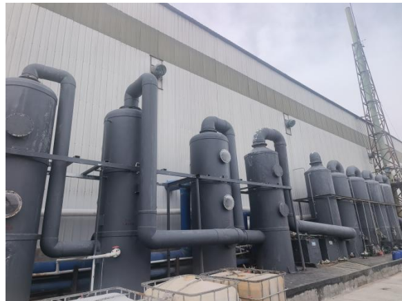
生产车间综合处理设施（车间公用）
