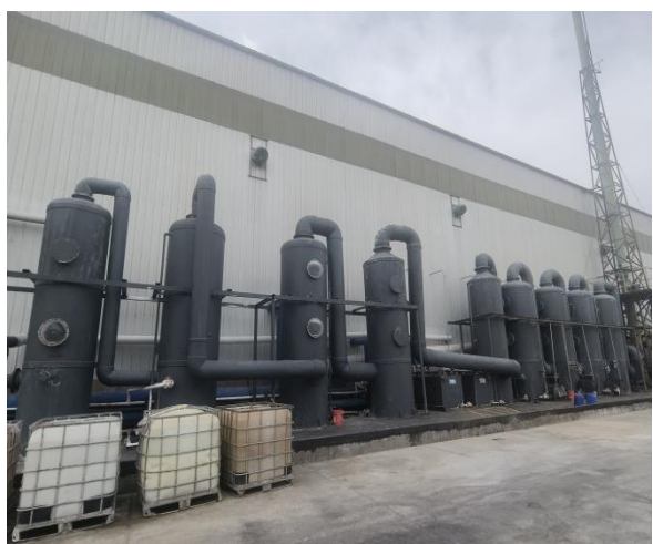
生产车间 1#废气处理系统
