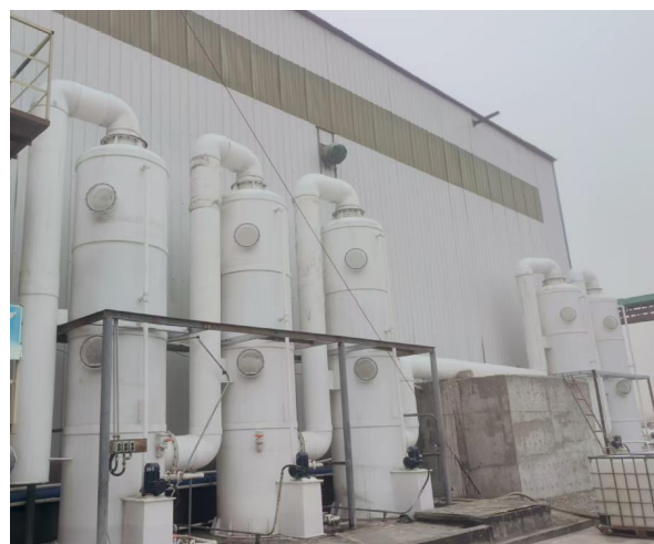
生产车间 2#废气处理系统
