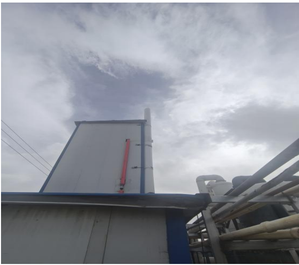
污水处理站废气排放口
