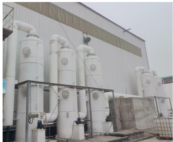
生产车间 2#废气处理系统
