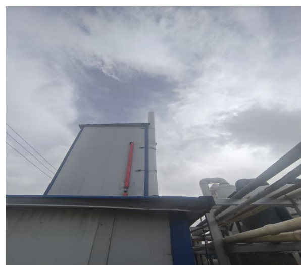
污水处理站废气排放口
