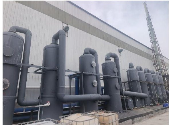
生产车间综合处理设施（车间公用）
