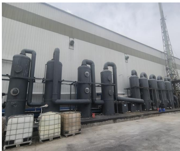
生产车间 1#废气处理系统
