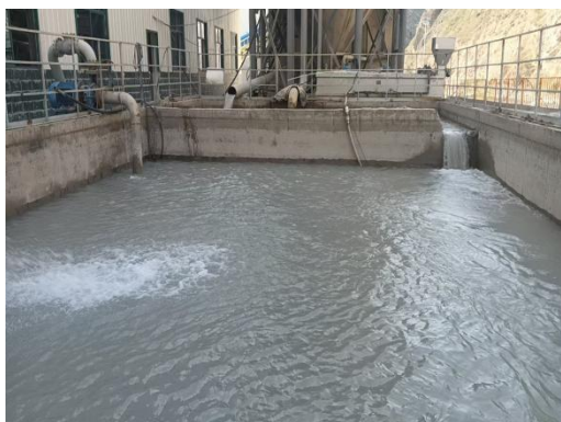
沉淀池和清水池
