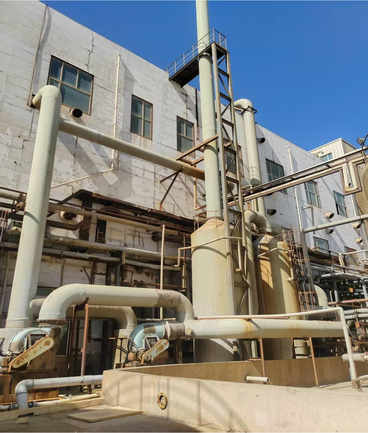
氯化单元填料式碱液吸收塔
