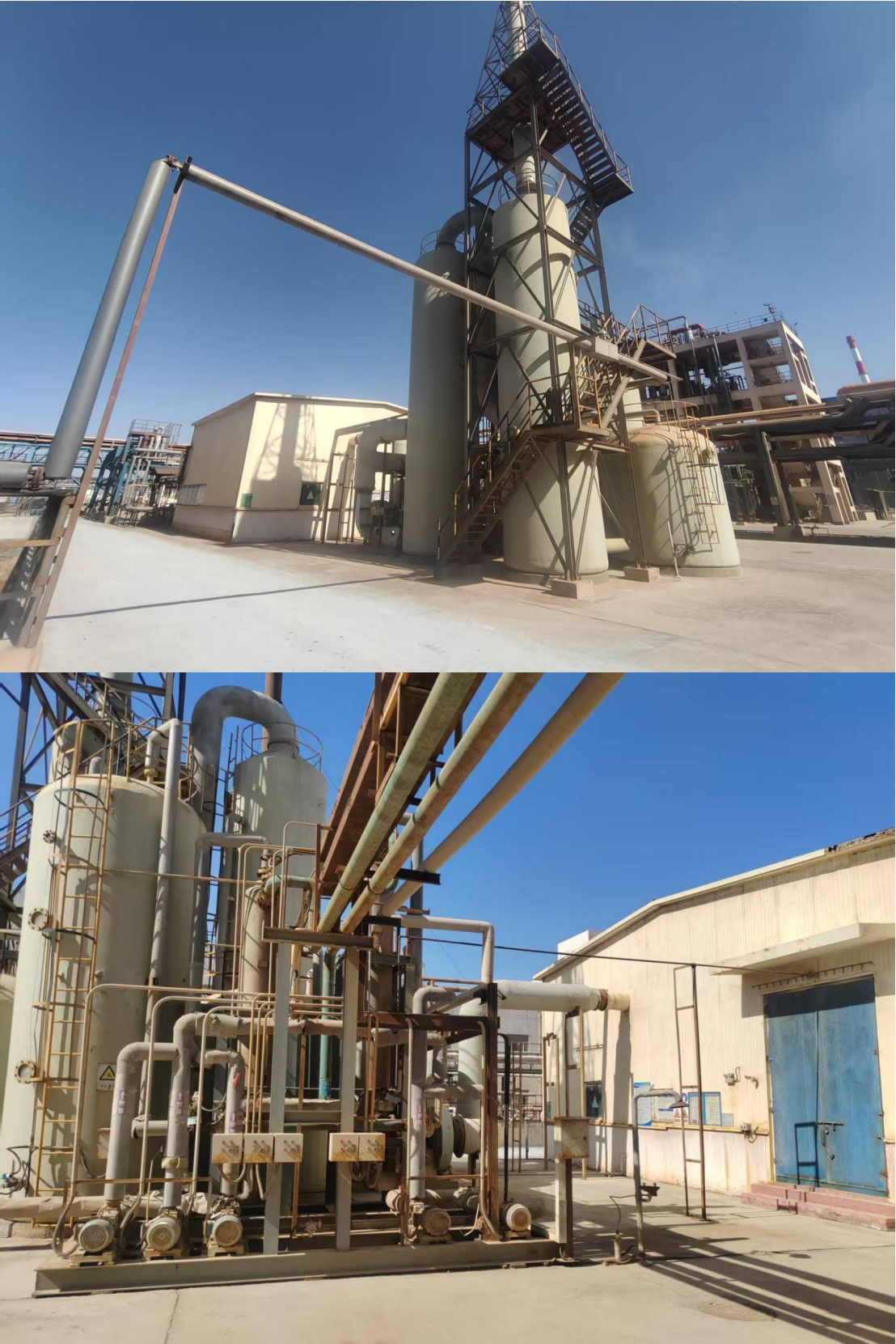
14.液氯库房双级碱液吸收塔+25m高排气筒
