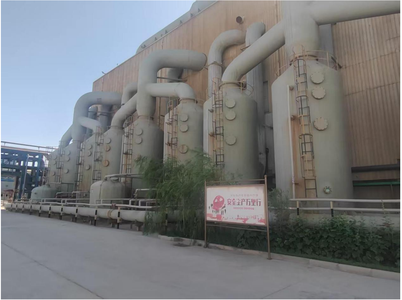
干燥单元填料式碱液吸收塔
