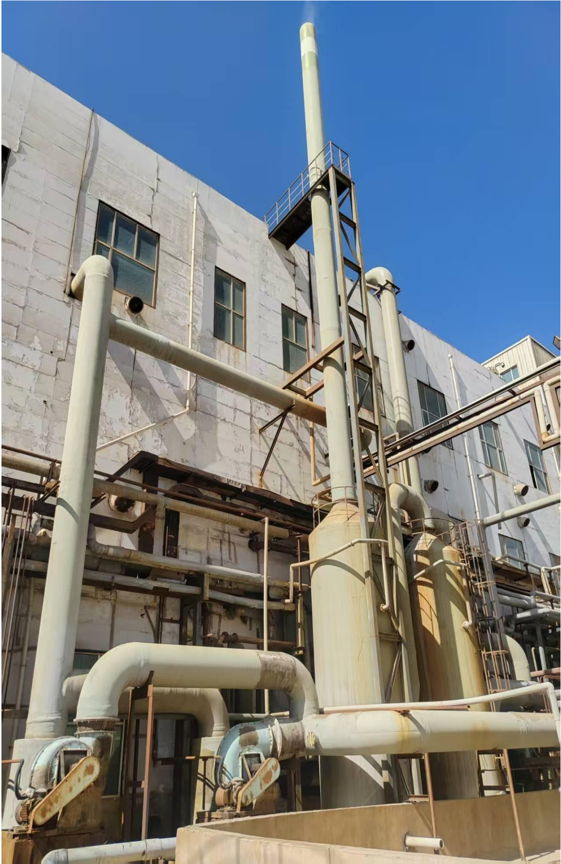
氯化单元排气筒
