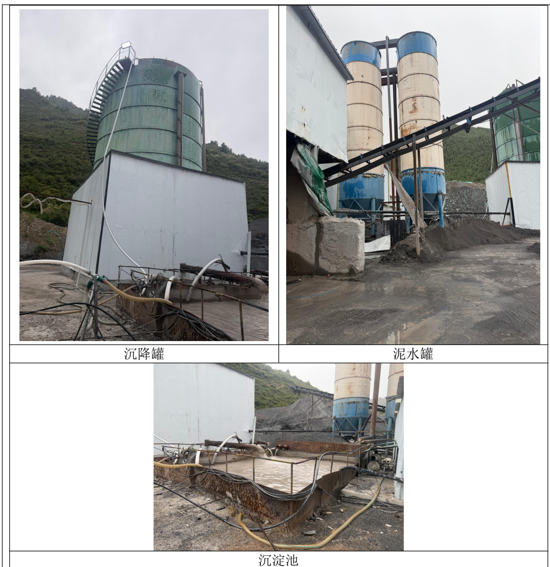
图 2-2 废水处理设施图
