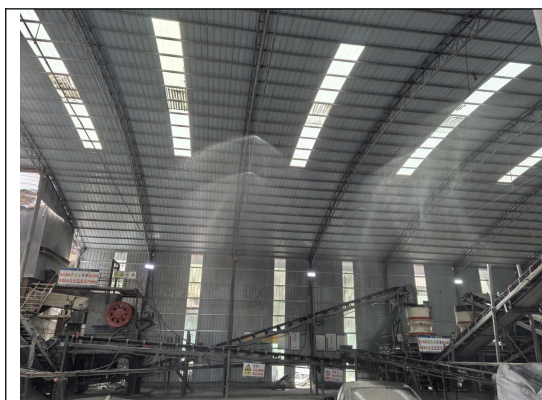
原料预处理车间喷淋系统
