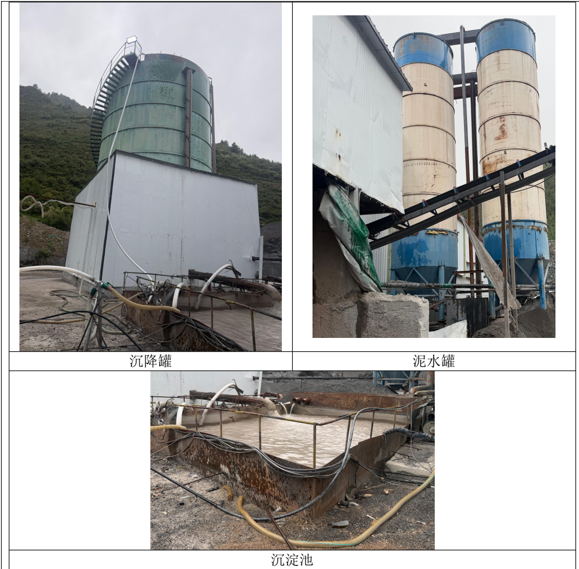
图 2-2 废水处理设施图
